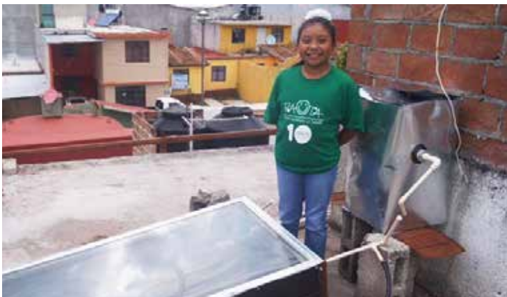
Com materiais reciclados, a mexicana Xóchitl Guadalupe Cruz López inventou o Banho Quente, um aquecedor de água alimentado por energia solar. O aparelho oferece à comunidade local acesso a uma fonte sustentável e barata de água quente.
